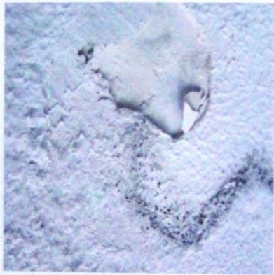
شکل ۸-۲۰: تصویر ذره بینی از شکل گیری قارچ بر دیواره داخلی ساختمان. [۲۰]
