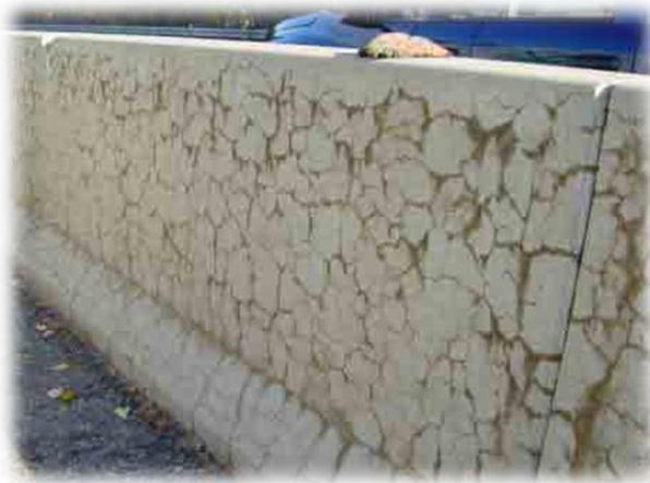
ترک های ناشی از واکنش ASR
